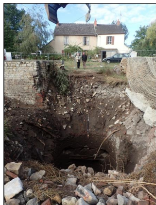
Effondrement tête de puit (Bézenet, 03)
